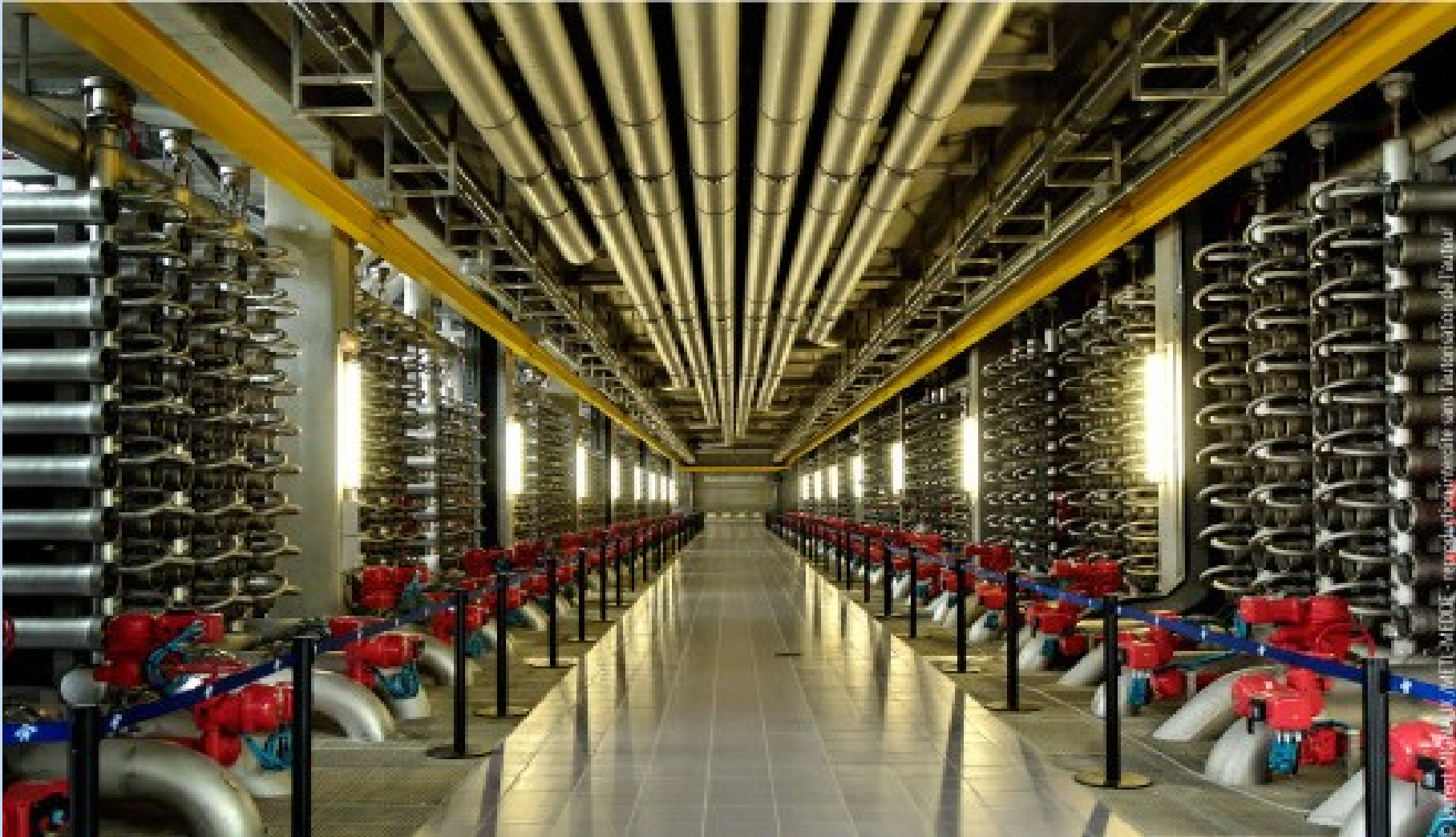
Usine de Méry Sous Oise/nano filtration
