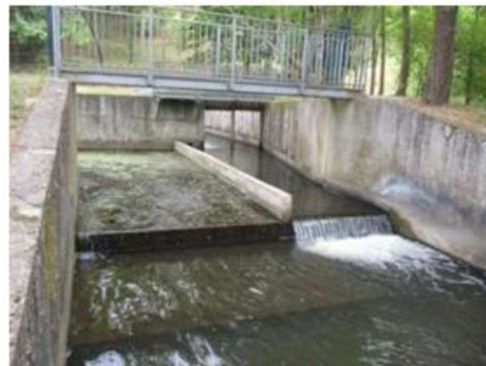
Restitution du décanteur
