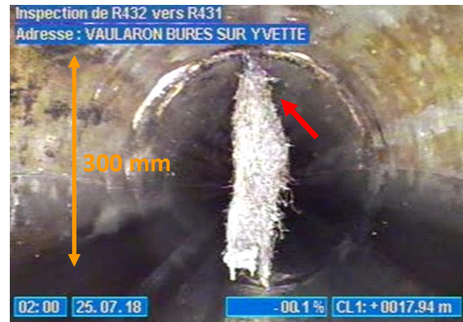
Fissures et pénétrations de racines
