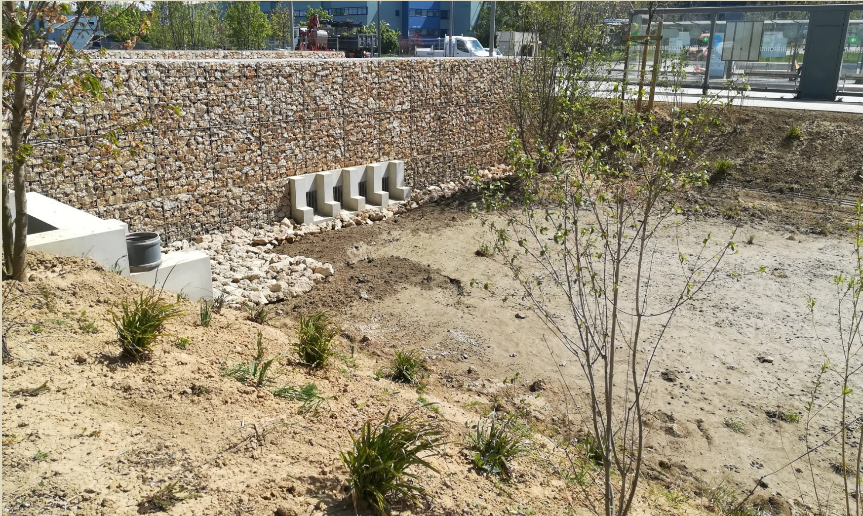
Rétention occurrence 20 ans débit de fuite 0,7l/s/ quartier du Moulon, 2022, Photo Pierre Farret
