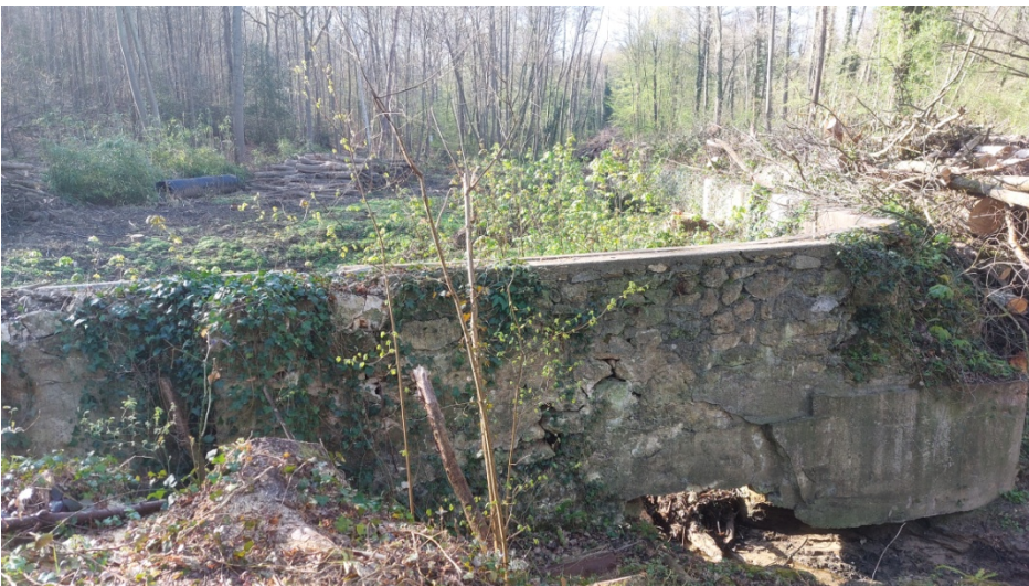
L'évacuation, ruinée, des eaux du ru d'Angoulême sous le mur de l'ex bassin piscicole
